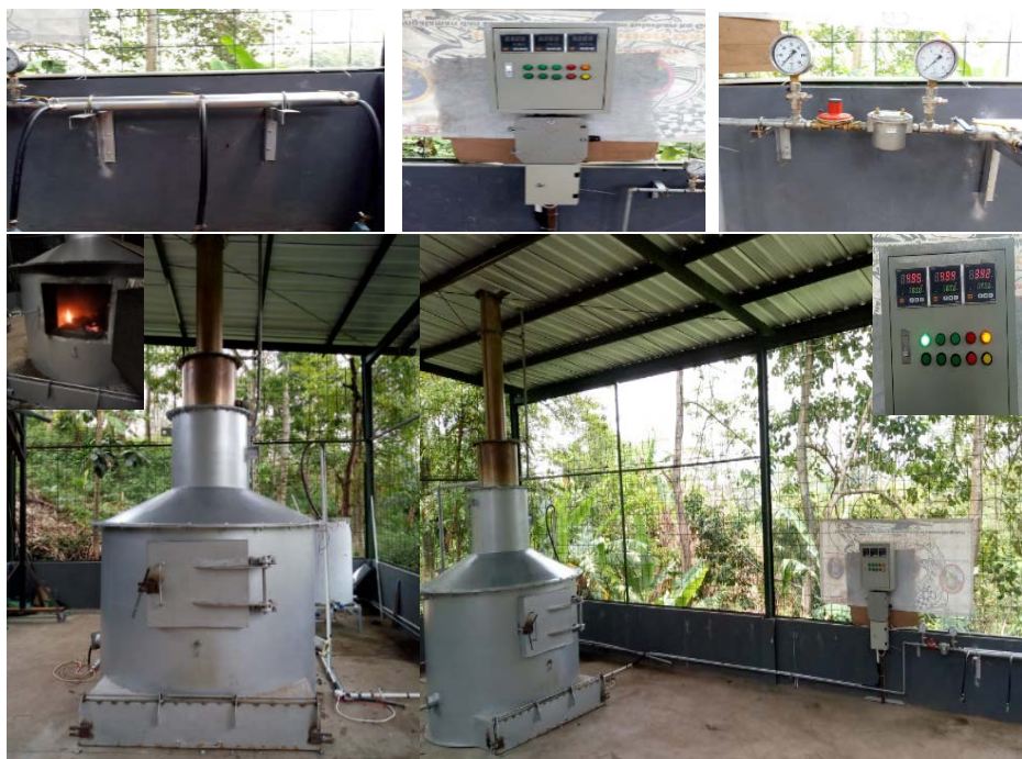
Gambar 3.26. Incinerator generasi-1 (ditempatkan di Kampus UP)
